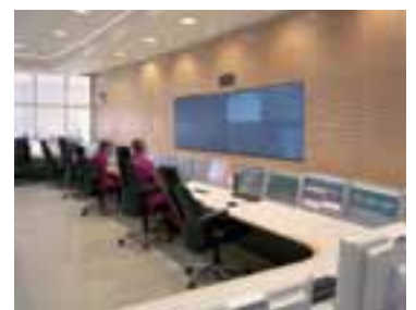
Meetkamer van de Clauscentrale in Maasbracht
